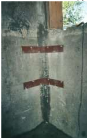
5. Plaques d'acier pour fissure mineur
